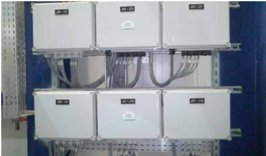
Instalacja odsiarczania spalin – Grupa Azoty PUŁAWY – zastosowanie przewodów BIT 500® i BIT500® CY produkcji ZK BITNER
