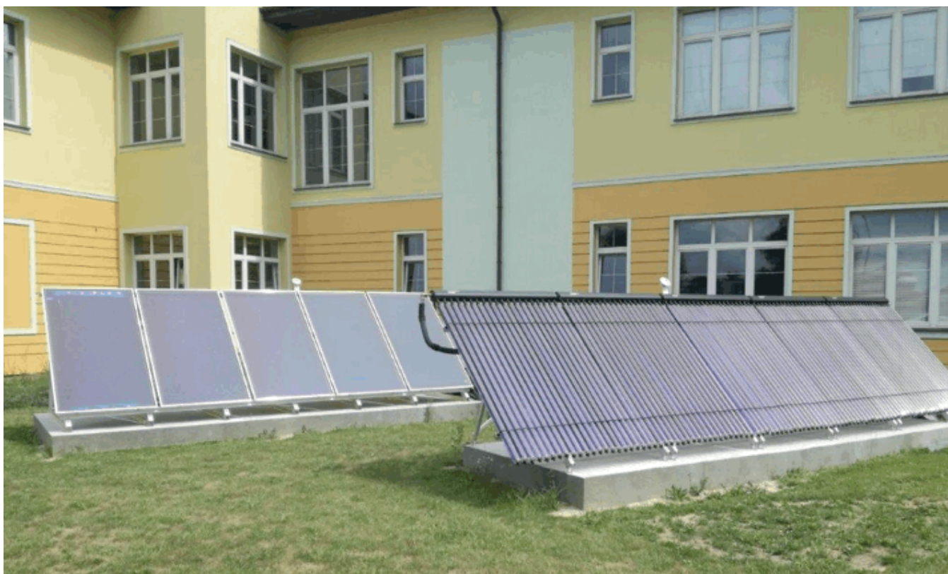
Fot.1 Stacja kolektorów słonecznych na Wydziale Inżynierii Produkcji SGGW w Warszawie
